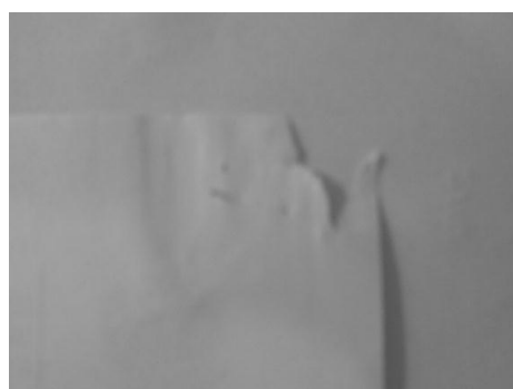
D – Deterioração por rasgos.
